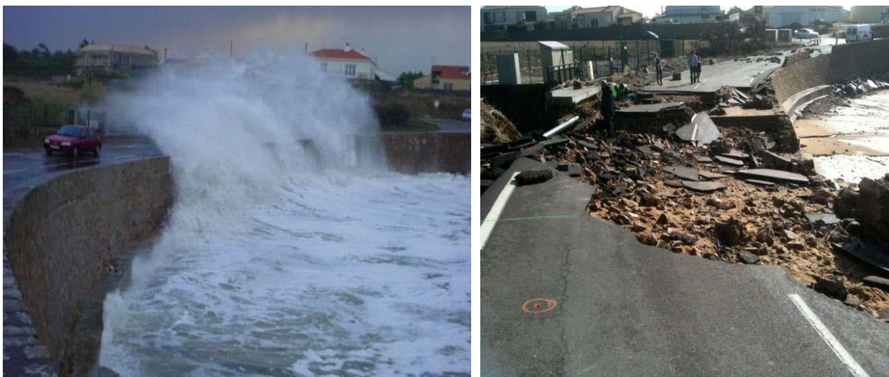
Figure 8 : Photographies illustrant la violence de la tempête Xynthia de 2010 et les dégâts provoqués sur la route du littoral (RD32A) au niveau de l'Anse de la Parée. (Source dossier)
