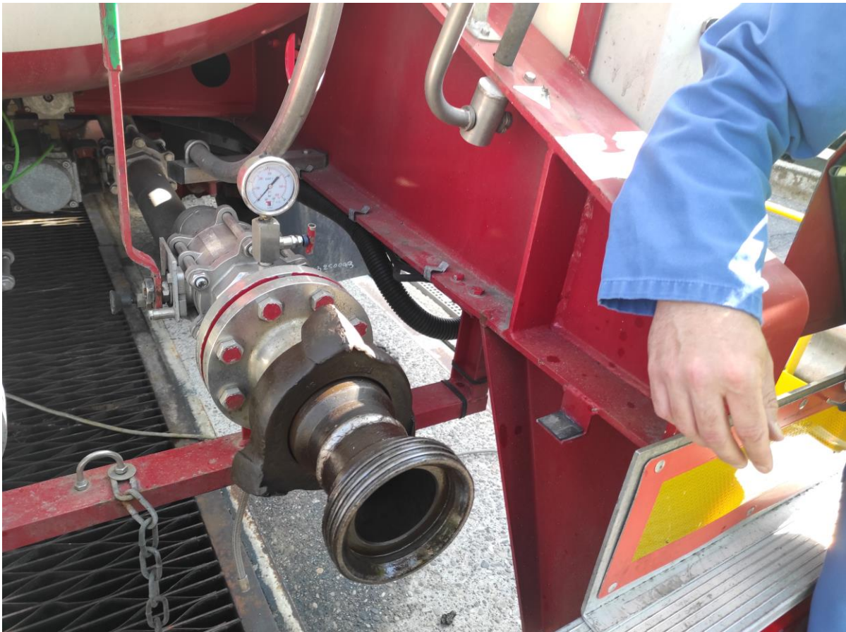
Photographie 2 : Manchette de raccordement fixée sur le raccord du camion-citerne
