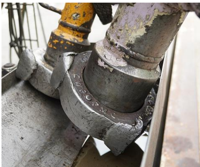
Photographie 3 : les oreilles de l'écrou à frapper sont de forme triangulaire et non parallélépipédique ce qui traduit une usure de l'écrou;
