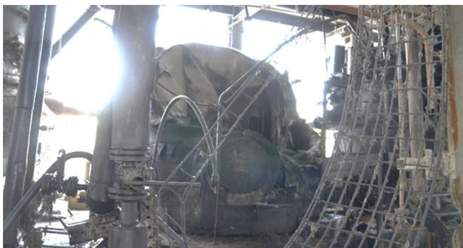
Photographie 2 : capacité éventrée, chemins de câbles affaiblis
