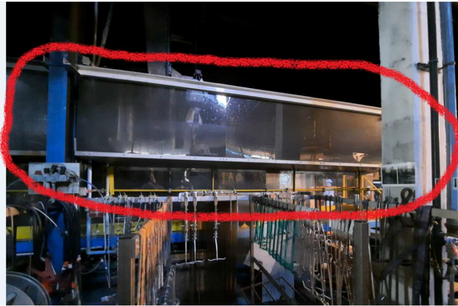
Photo 5 : Les plexiglas anti-éclaboussures situés aux extrémités des chaînes de traitement de surface n'ont pas été consumés par l'incendie.
