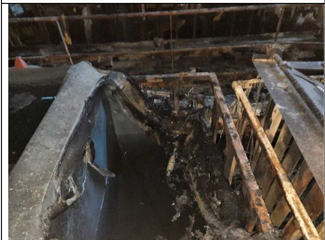
Photo 19 : Vue d'un baign d'acide ayant fondu mais ayant conservé une partie de sa solution
