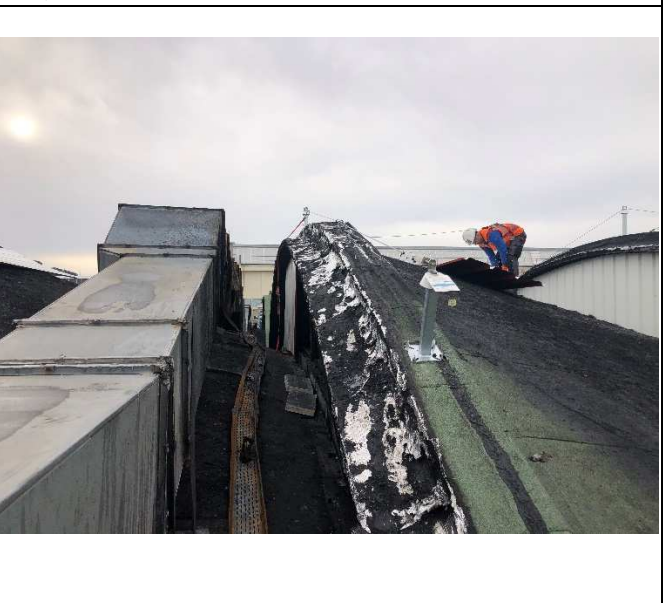
Photo 13 : Vue des exutoires de fumée en toiture (Source AH)
