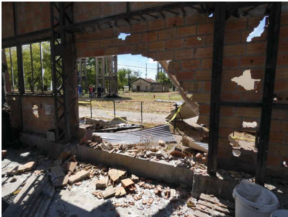
Figure 6 : Perforations du mur en briques
