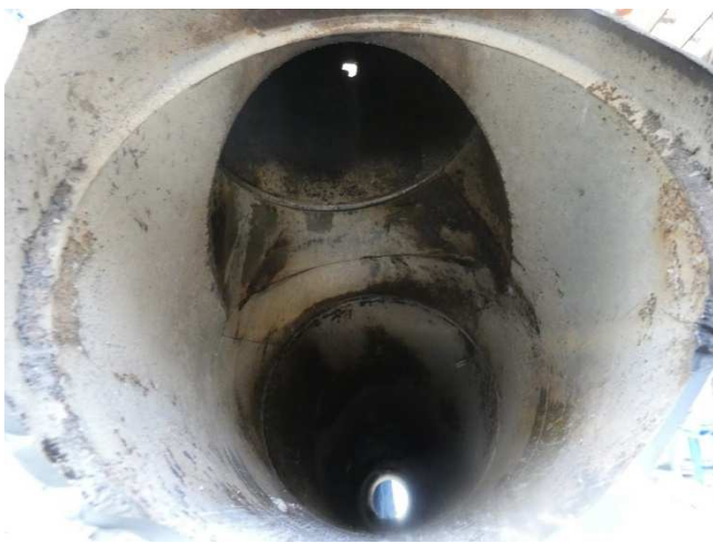
Photo 17 : Reste de nitrocellulose présent dans les canalisations de transport des eaux blanches
