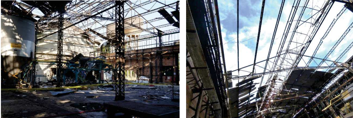
Figure 10 : Dégâts subis par la couverture de toiture – partie Sud
