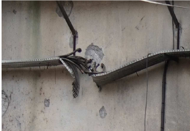
Photo 15 : Chemin de câbles tranché par un projectile avec impact dans le mur
