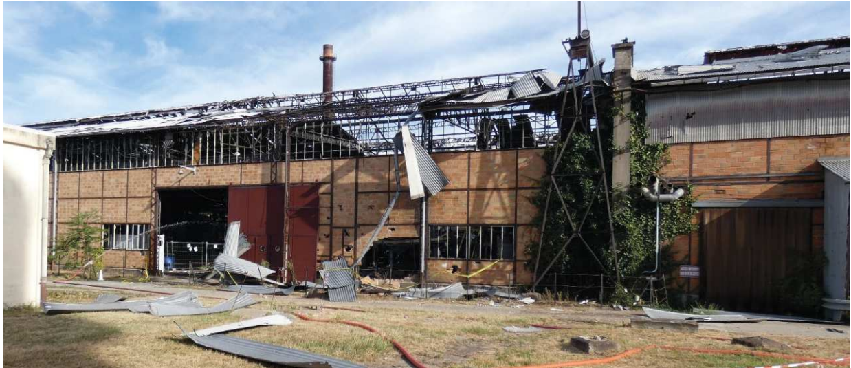
Figure 5 : Dégâts en façade Sud du bâtiment
