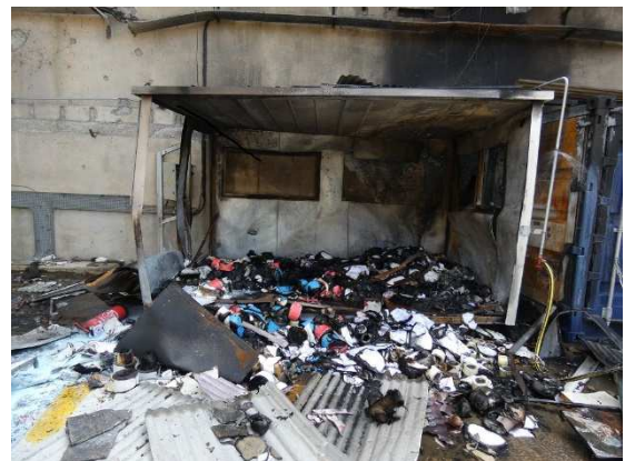
Photo 10 : Vue du local de stockage des saches plastiques et étiquettes après l'incendie
