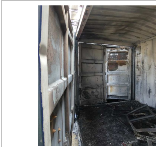
Photo 7 : Vue de l'intérieur du container maritime qui présente des déformations globales de l'ensemble des parois.
