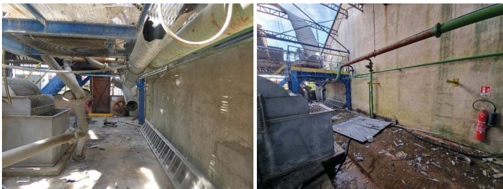
Figure 16 : Rupture sur tout le long de la canalisations PVC reliant les tamiseurs à la cuve « eaux blanches » n°2
