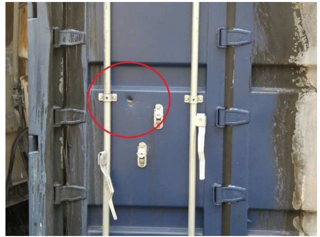
Photo 8 : Impact d'un effet missile sur la porte du container ayant traversé celle-ci.
