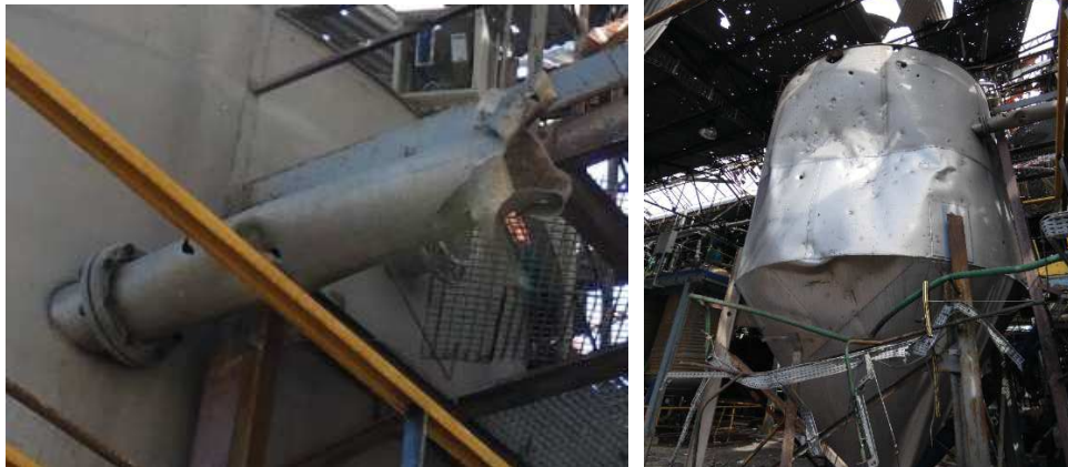
Figure 17 : Rupture de la tuyauterie entre la cuve « eaux blanches » n°2 et le décanteur et perforation de celle-ci (à gauche) et déformation et nombreuses perforations du décanteur (à droite)
