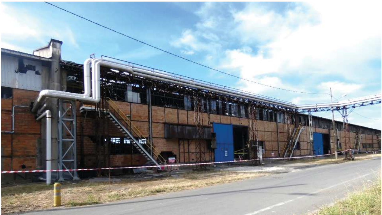
Figure 4 : Dégâts en façade Nord du bâtiment
