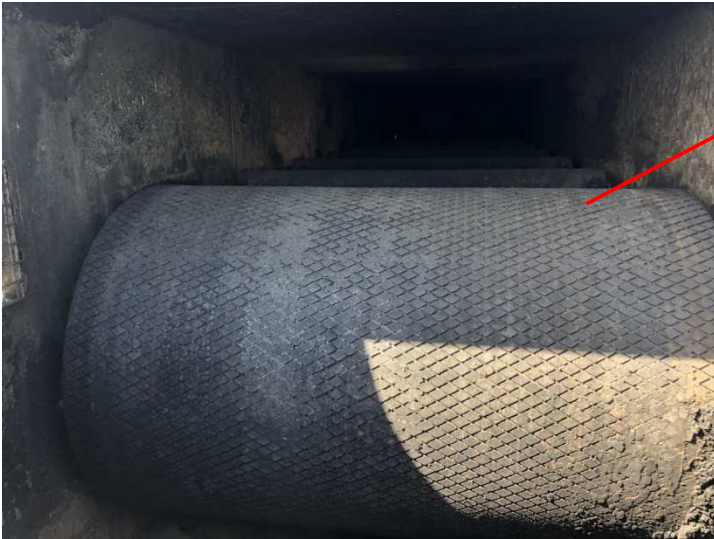
Figure 10 : Photo du rouleau de renvoi de la bande à bords situé en partie haute du silo 4000. La bande de roulement de cette dernière est en bon état.
