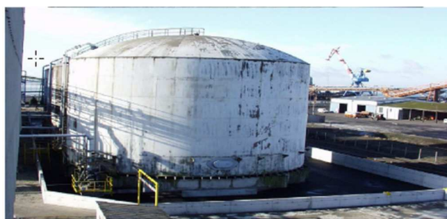
Photo 5 : Réservoir d'acide phosphorique
