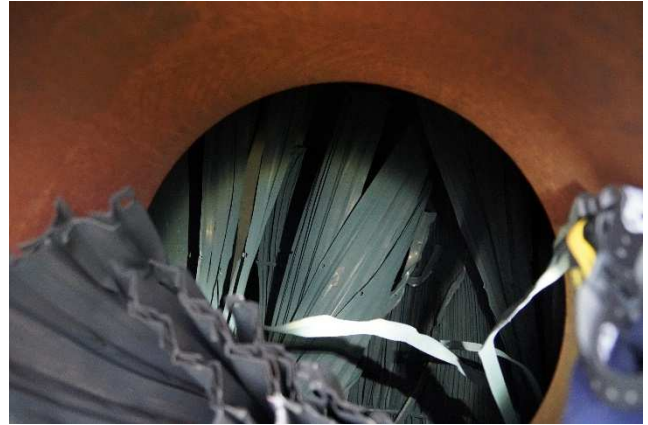
Photographie 4 : enchevêtrement des lamelles métalliques internes au filtre déformées par le souffle de l'explosion
