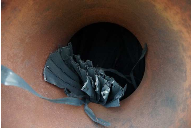
Photographie 3 : lamelles métalliques du filtre expulsées par le souffle de l'explosion par la conduite supérieure
