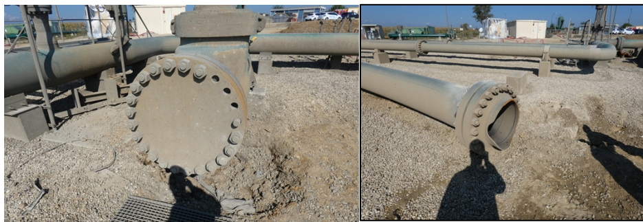
Figure 15 : A gauche la bride du clapet 505 avec 3 vis manquantes – à droite, rupture en traction axiale au niveau de la lyre
