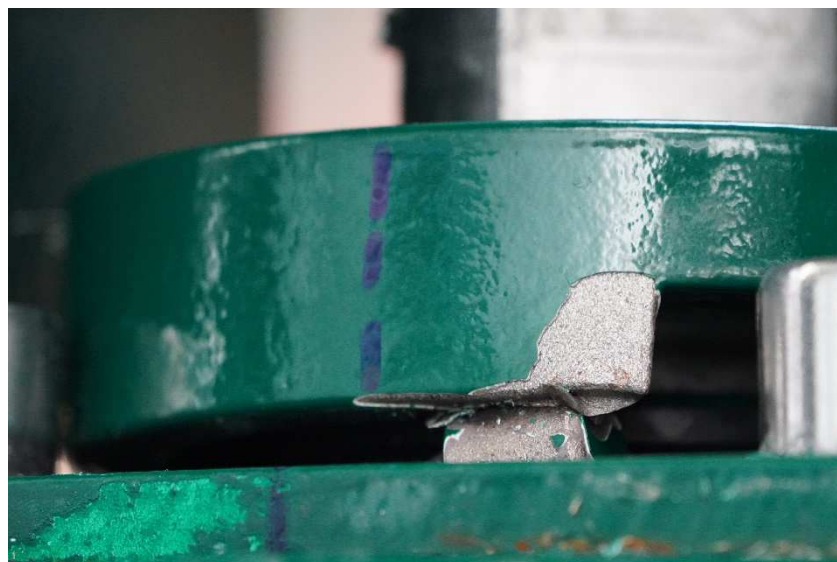
Photographie 10 : butée de positionnement détériorée
