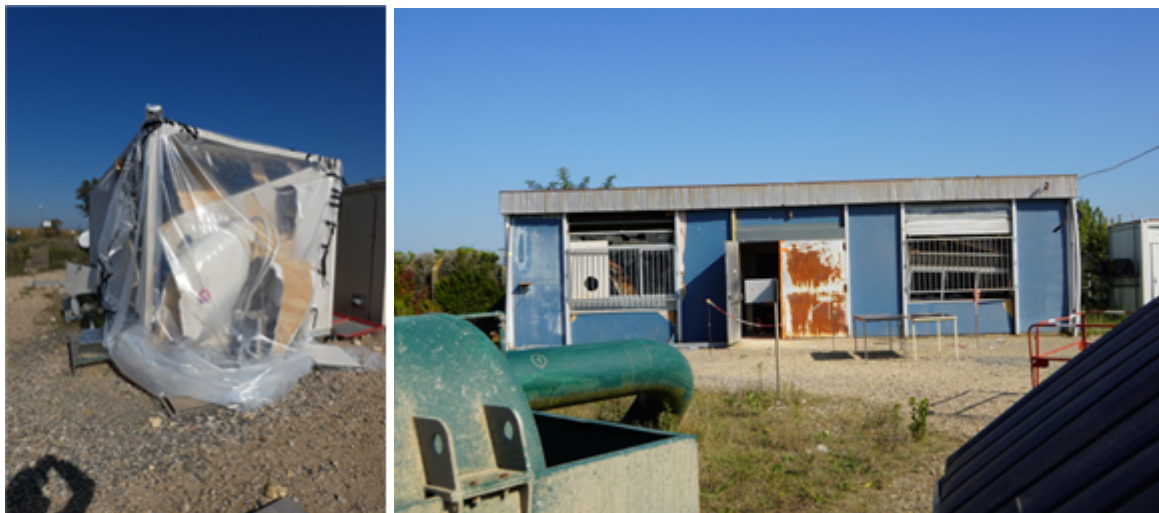
Figure 6 : dégâts sur les bâtiments – à gauche, le local technique à 25 m ; à droite, locaux préfabriqués à l'entrée du site, à 70 m.
