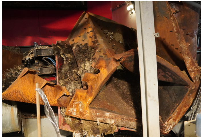
Figure 3 : Photographies des dégâts
