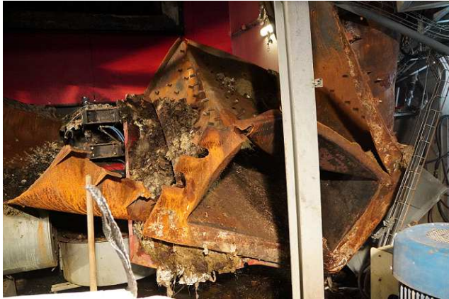
Photographie 8 : Vue de la goulotte de la chaudière n°2 après l'accident, avec sa double coque éventrée au-dessus.
