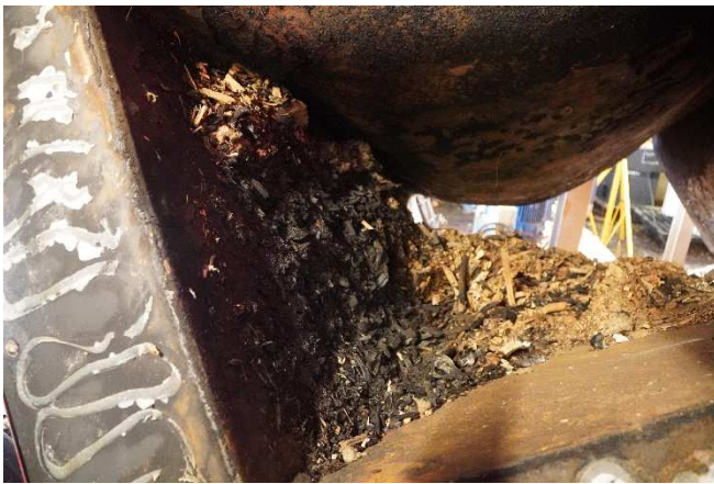
Photographie 9 : Vue de la partie intérieure de la goulotte qui permet de visualiser une déformation de la paroi vers l'intérieur de la goulotte.
