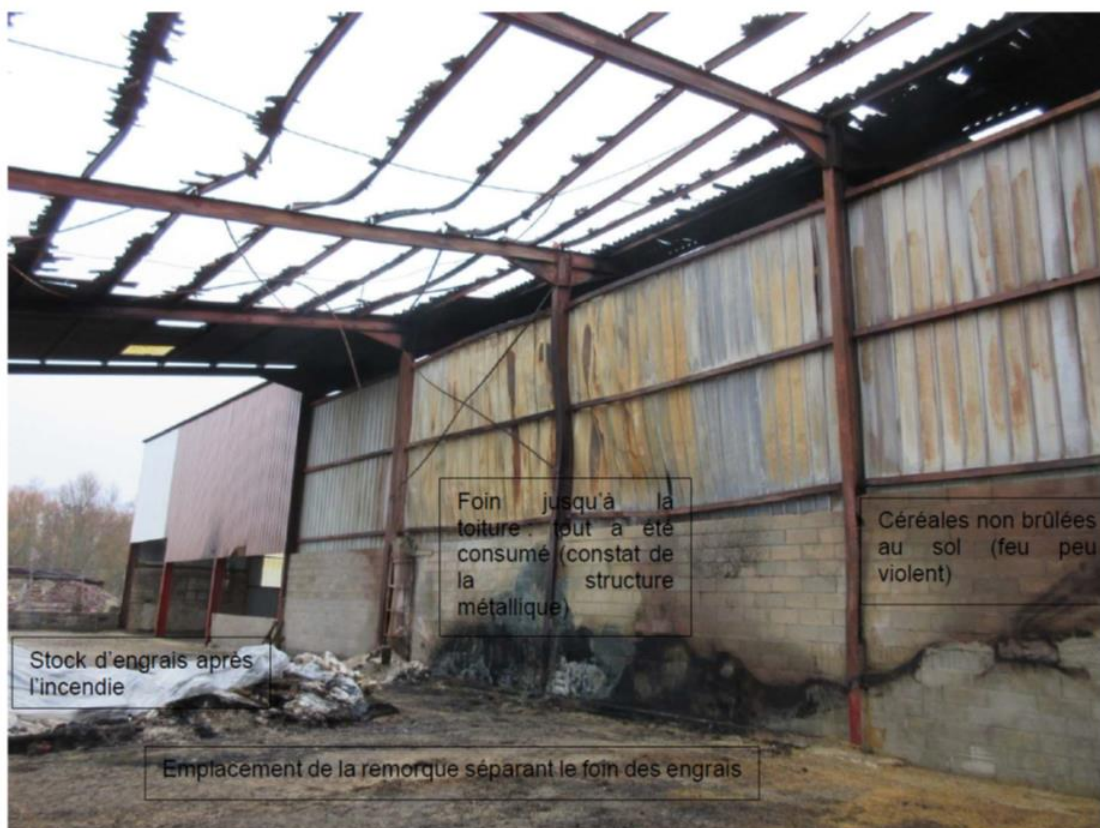
Figure 8 : Incendie à proximité du stockage des engrais
