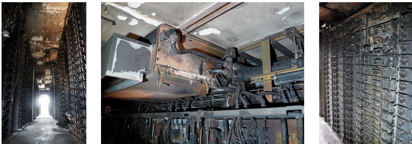
Photographie 7 : la photo de gauche donne un aperçu de l'état général des modules et du plancher du conteneur, la photo du milieu permet de visualiser les traces d'incendie, la photo de droite permet de visualiser les dégradations constatées sur les racks 2 et 3 du BSC 2.
