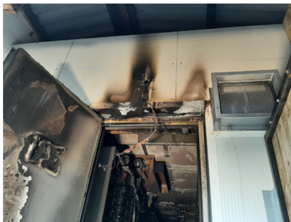
Figure 11: Stigmates extérieurs laissés par l'incendie au-dessus de la porte d'entrée de la façade nord
