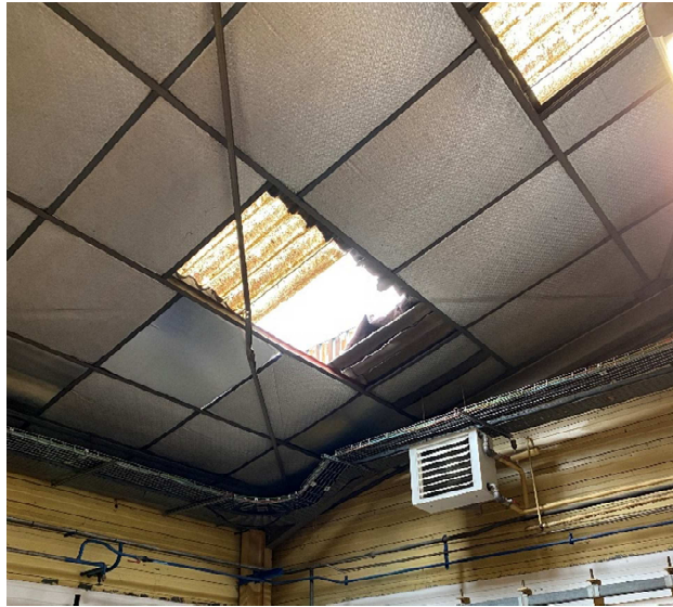
Figures 1, 1 et 3 : dégâts observés au sein de l'atelier AEB (atelier entretien bouteilles)
