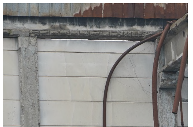
Photographie 9 : mur intercellule 1-2 qui fait apparaître un espace entre le mur et la poutre qui est particulièrement détériorée (ferrailles apparentes)
