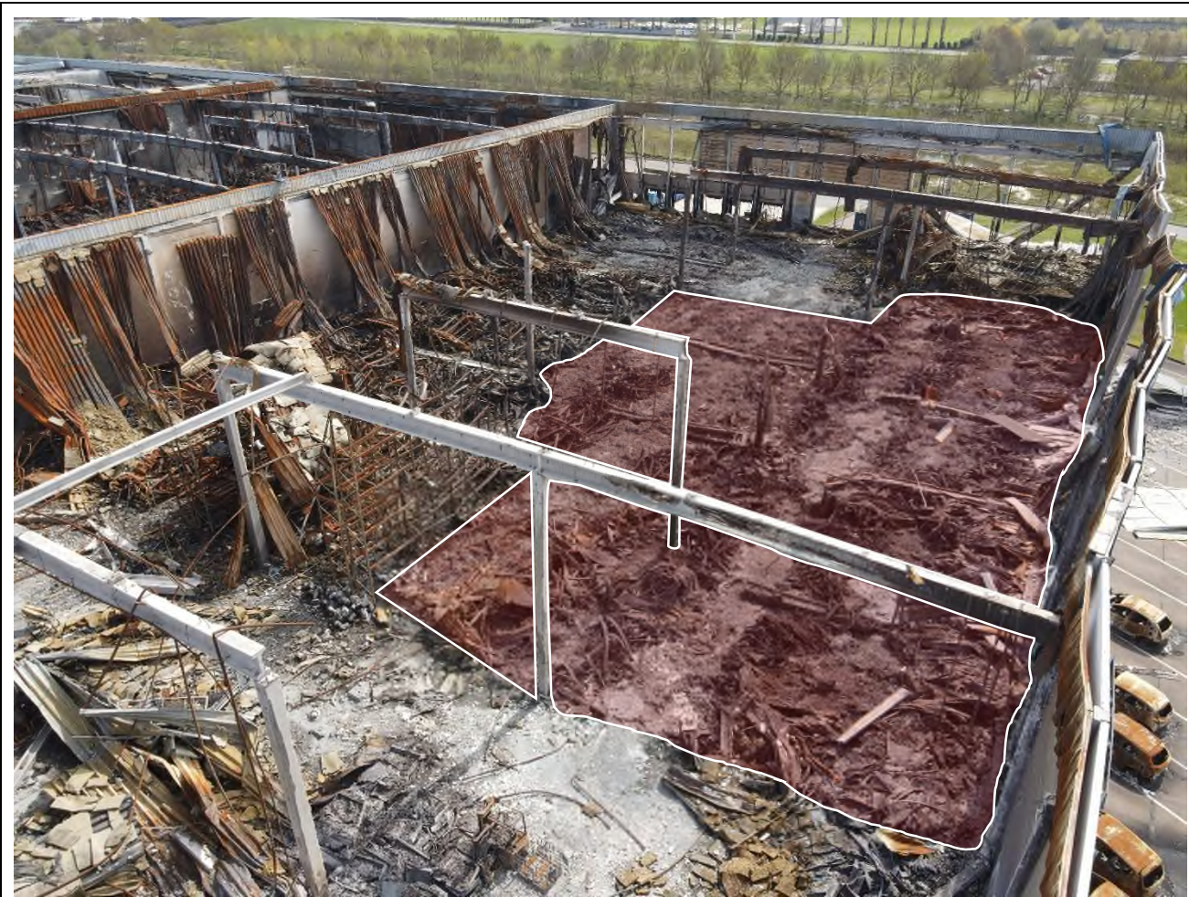
Photographie 11 : Vue de la cellule 1. En Rouge, la zone au sein de laquelle les traces d'incendie sont le plus marquées (disparition quasi totale des racks et des éléments de la toiture), présence au sol d'une épaisse couche de résidus de combustion. Le mur périphérique extérieur a subi des dommages importants qui ont localement conduit à son effondrement vers l'extérieur du bâtiment (cf. Photographie 14). Les atteintes à la structure (poutre béton) sont notablement plus importantes en comparaison celles constatées sur la cellule voisine, où étaient stockés 70 000 pneumatiques.
