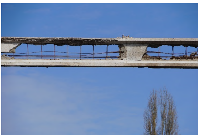
Photographie 12 : La majorité des poutres constituant la structure du toit se sont effondrées pendant l'incendie. Celles restées en place montrent qu'elles ont été exposées à des températures importantes.
