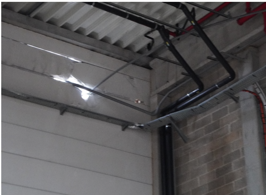
Photographie 19 : détérioration du mur autour du passage de la tuyauterie de chauffage.
