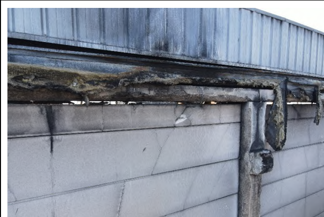
Photographie 17 : Vue de la partie supérieure du mur intercellules 2-3. Un espace est clairement visible entre la dernière plaque de béton et la poutre.
