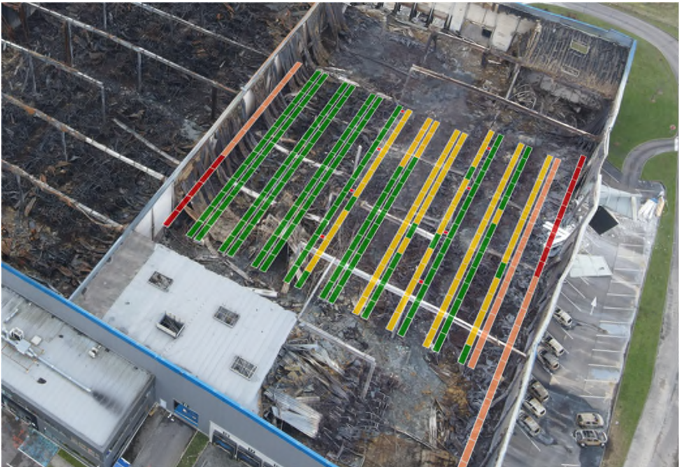
Photographie 40 : Vue de la cellule 1 et en superposition une représentation de la densité de stockage des batteries sur les différentes travées de racks. Plus la couleur est rouge plus il y a de modules dans les racks. On aperçoit la destruction partielle du mur en façade ouest à un endroit où la quantité de batteries est importante.
