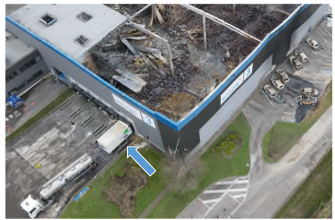
Photographie 7 : Remorque réfrigérée servant à la mise en sécurité des modules présentant des signes de dangerosité (Préconisation du fabricant Blue Solutions)
