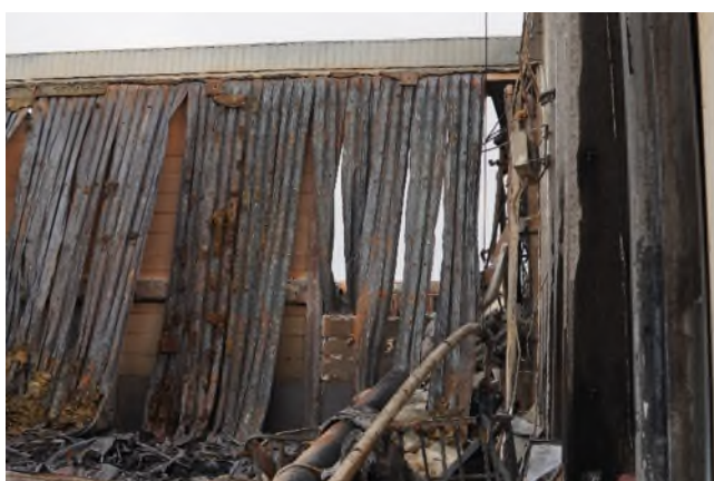
Photographie 8 : Portion de mur intercellules 1-2 détruite du côté de l'arrivée des tuyauteries du système de sprinklage.
