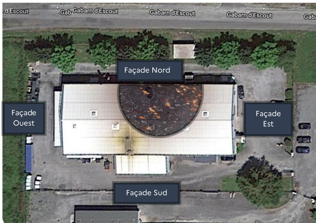
Photographie 3 : Vue aérienne du site. La zone noircie représente la zone d'effondrement de la toiture.
