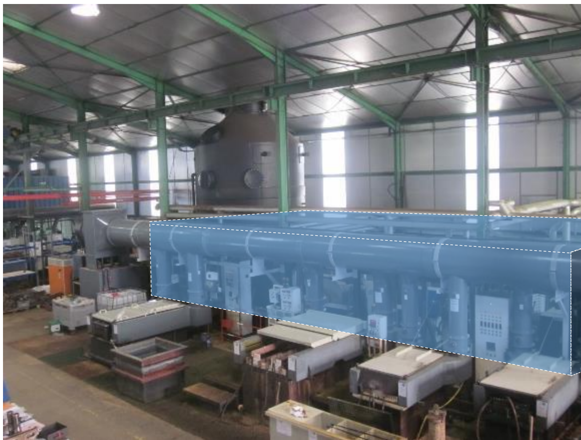
Photographie 5 : vue de la ligne de traitement de surfaces et de la zone où ont été constatés les défauts électriques.
