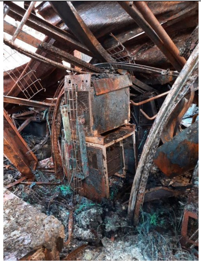
Photo 10 : photo d'un des postes redresseur associé à un bain.
