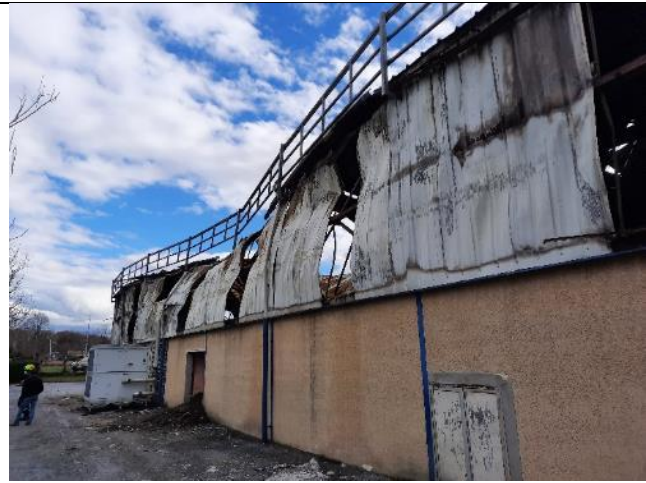
Photo 4 : Vue extérieure selon prise de vue n°4. Cette façade présente les désordres structurels les plus importants.
