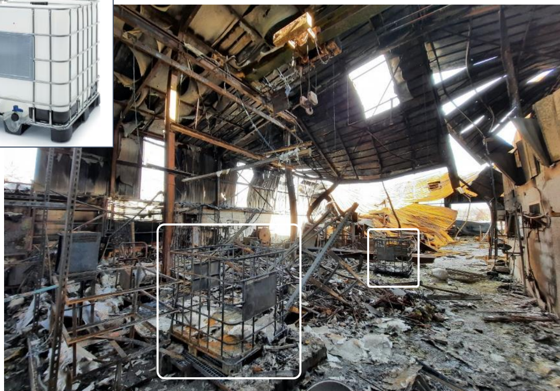
Photographie 7 : Cage métallique de GRV pris dans l'incendie.
