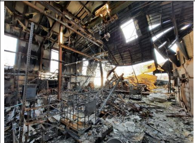
Photo 11 : vue intérieur du bâtiment de production ( prise de vue F ) qui permet de voir les déformations thermiques les plus importantes en second plan.
