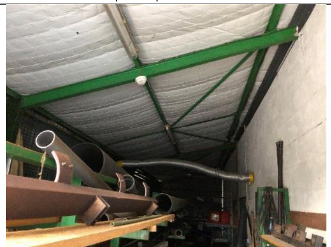
Photo 8 : photo du local de matériels adjacent au local de produits dangereux. On y distingue clairement la présence d'un détecteur de fumée.
