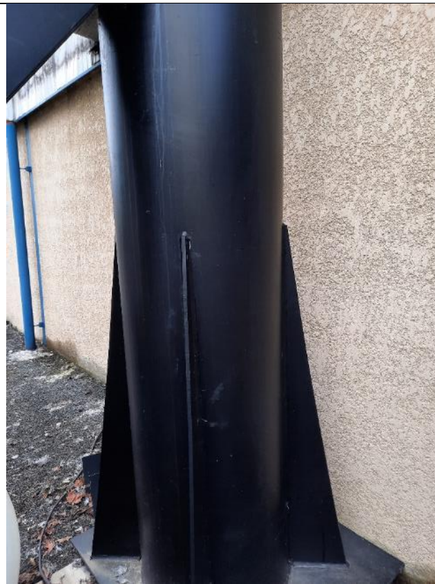
Photo 12: Eléments extérieur de l'équipement de lavage des vapeurs
