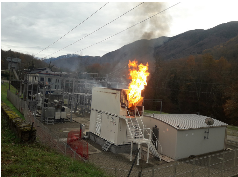
Incendie d'un conteneur à batteries (RTE - Perles-et-Castelet- 09).
