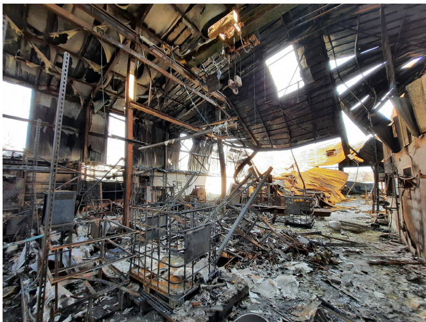
Atelier de traitement de surface après incendie - STI France - Escout - 64.
