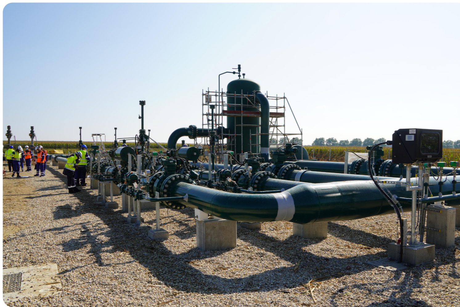
Station d'interconnexion GRTgaz - Ars-sur-Formans (01).
