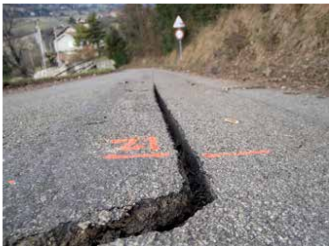
Affaissement de terrain (Isère, 2011) © IRMA/S. Gominet
