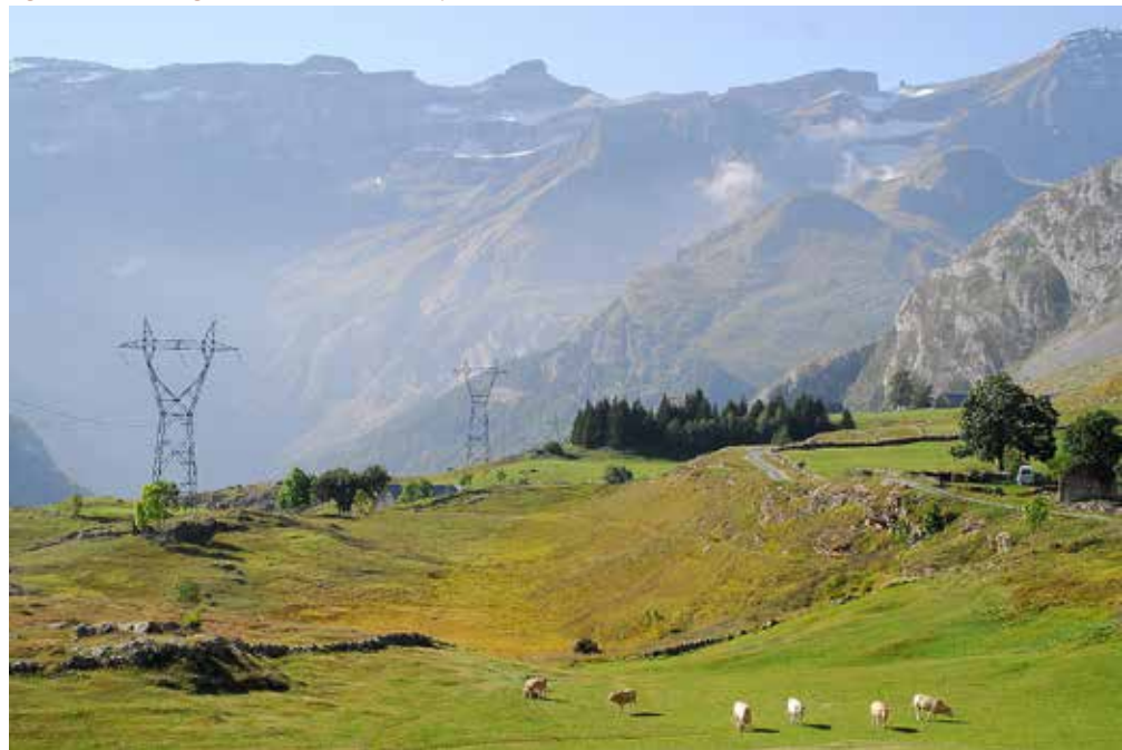
Ligne 225 KV La Pragnères-Biescas dans le cirque de Gavarnie (65) © Bachelet Antoine
