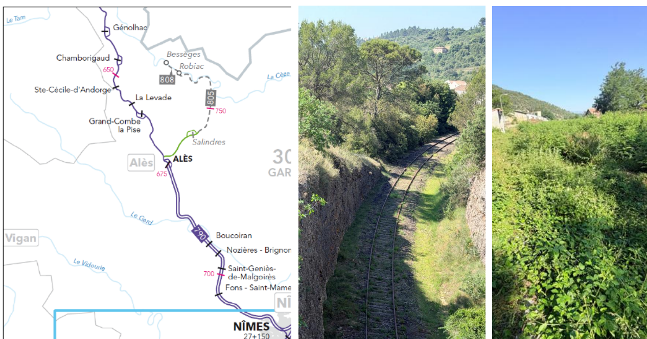
Figure 1 : plan de situation (à gauche, source : dossier) et vues de la plateforme ferroviaire au centre (à Saint–Ambroix) et à droite (à Molières–sur–Cèze, sous la végétation) (source : rapporteurs)
