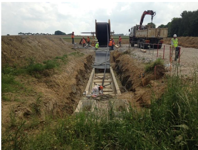
Figure 2 : Chambre de jonction et puits de terre au premier plan- Source : dossier
