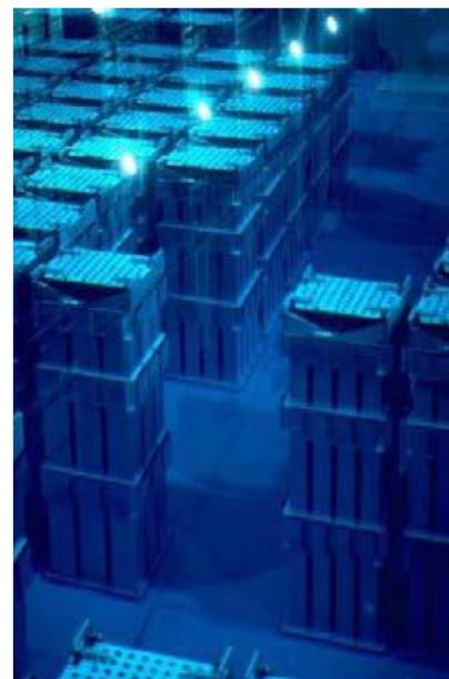
Figure 3 (droite) : Piscine d'entreposage des combustibles usés (source : dossier)
