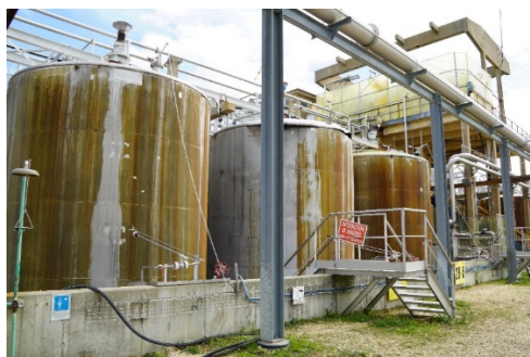
a. Cuve accidentée (au centre)
