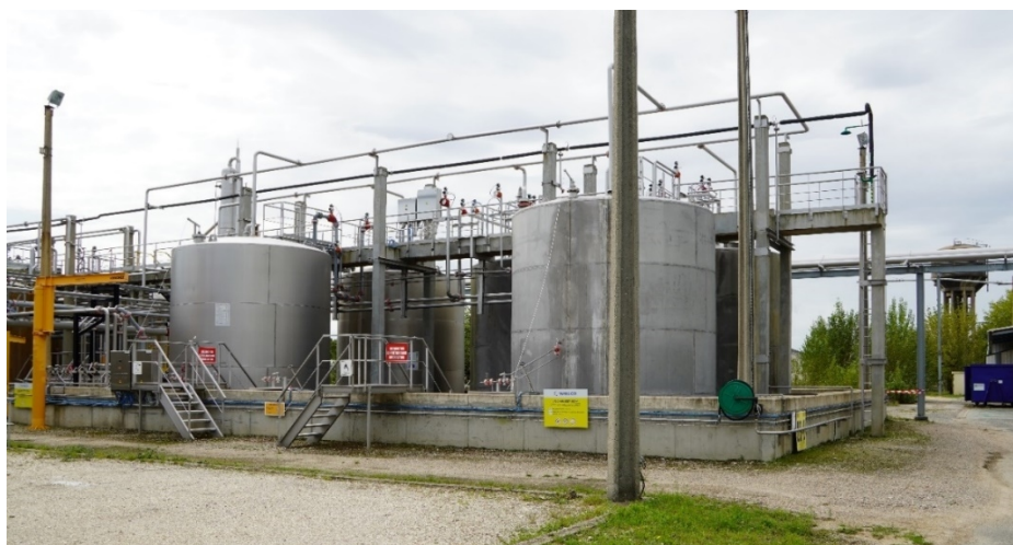
Figure 1. Photo du parc acides
