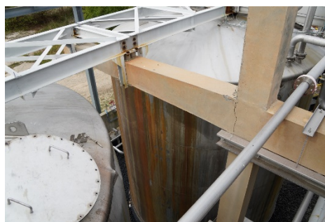
d. Fissuration des portiques en béton
