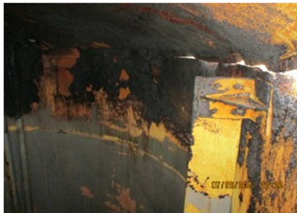
Photo 8 : Paroi intérieure du dôme dégradée
