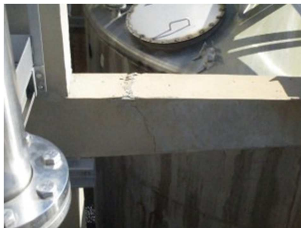
Photo 6 : Portique béton fissuré
