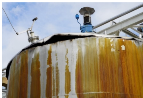
b. Déchirure de la soudure du dôme
