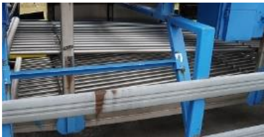
Figure 4 : Réchauffeur positionné sous la citerne
