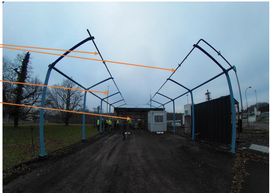
Figure 2 : poste de dépotage
