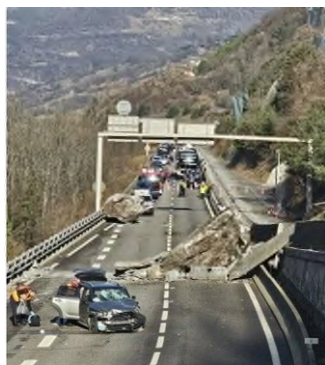
Éboulement RD 90 (©DR)
