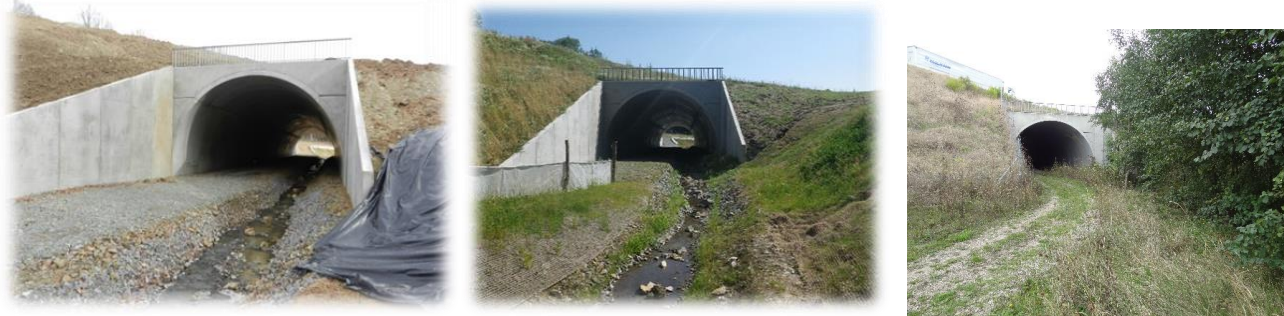
Figure 19 : OH 188 - Amont de l'ouvrage avant et après végétalisation des berges (© Biotope 2014 et 2015, © Egis / D. Ferreira 2020)
