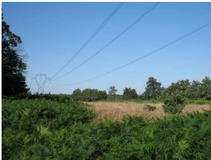
La ligne 400 kV Cubnezais – Plaud, à proximité du branchement du raccordement prévu
