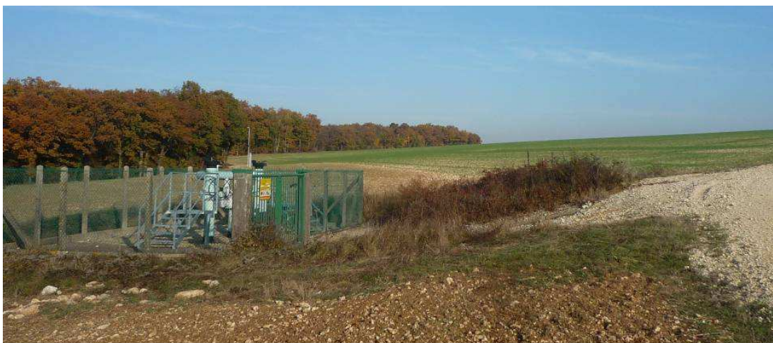
Figure 6 - Poste de sectionnement (entouré d'un grillage)
