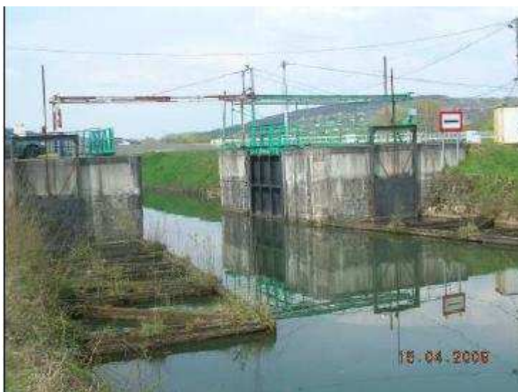
Porte de garde de Givet actuelle, vue depuis l'amont (extrémité sud du canal de dérivation)
